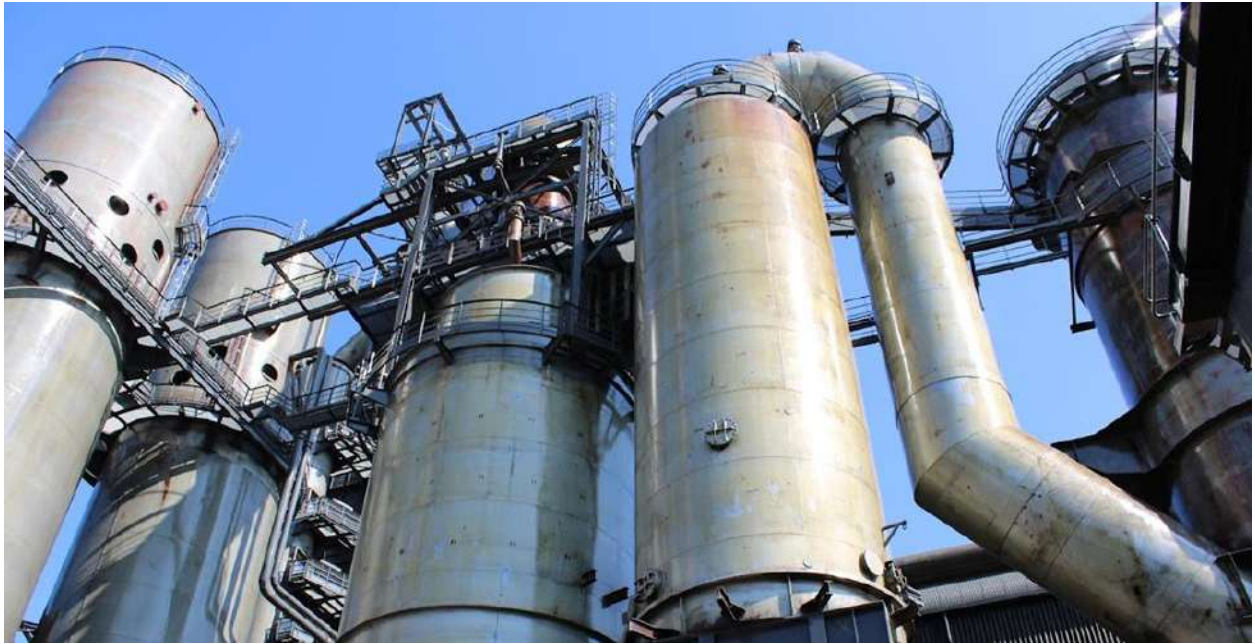
Vue sur les cowpers (récupérateurs de chaleur) et l'épuration des gaz de Haut Fourneau A à Belval.
