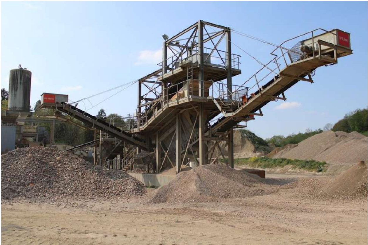
Installations de criblage qui sépare les granulats recyclés en fractions différentes.
